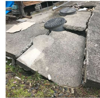
浄化槽破損状況
