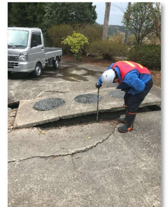
浄化槽破損確認状況
